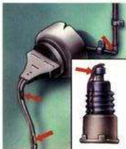
Неисправность электропроводки Пользование самодельными предохранителями
